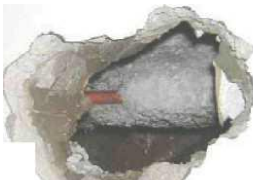
Rys. 7 Azbestowa izolacja rury
