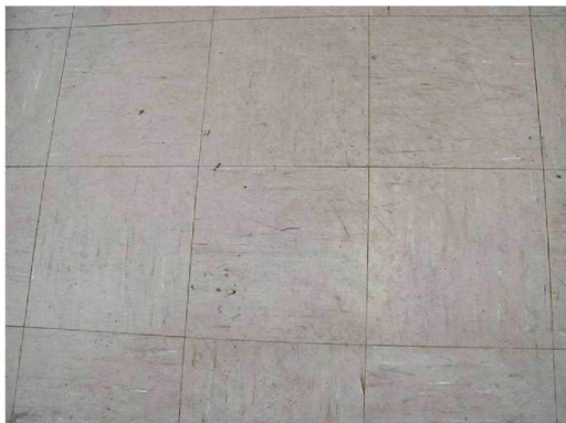
Rys. 8 Płyta podłogowa azbestowa
